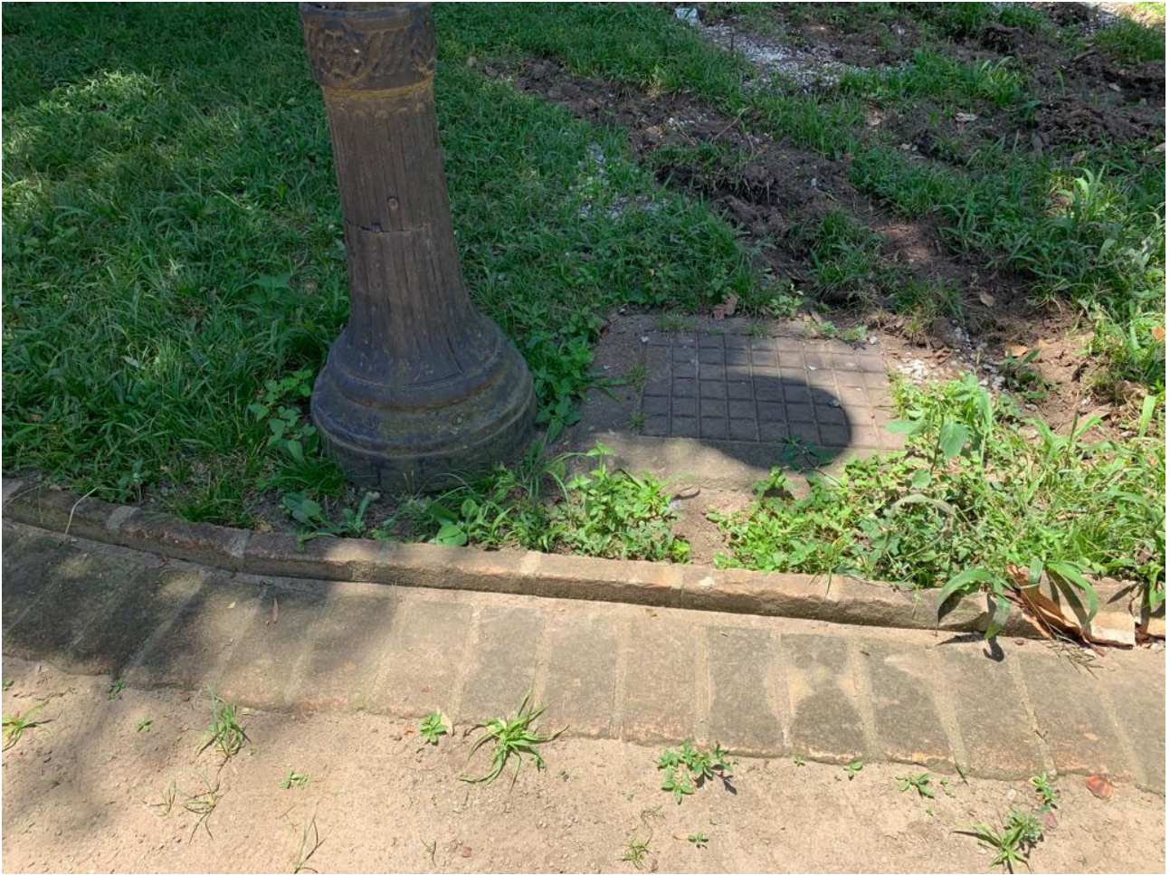
Foto 2: Vista da base do poste histórico, caixa de manutenção e arremate em tijolos do Jardim.
